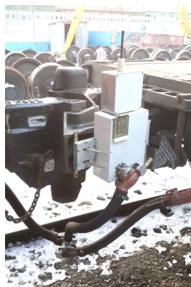
Фото 1. Тройник 230Д.30.300 установленный между вагонами
